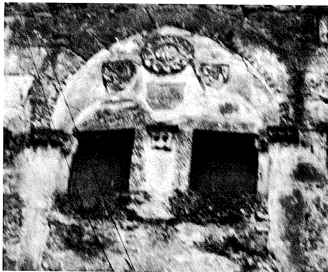
La bifora del palazzo nei pressi della chiesa del Carmine con gli emblemi ormai molto deteriorati
